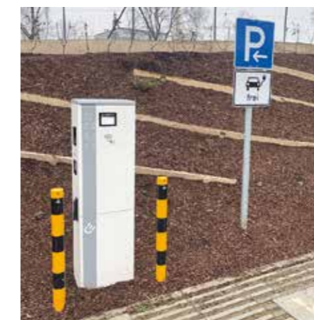
Weitere Ladestationen in Bodenwöhr sind geplant. Foto: R. Ahrens
